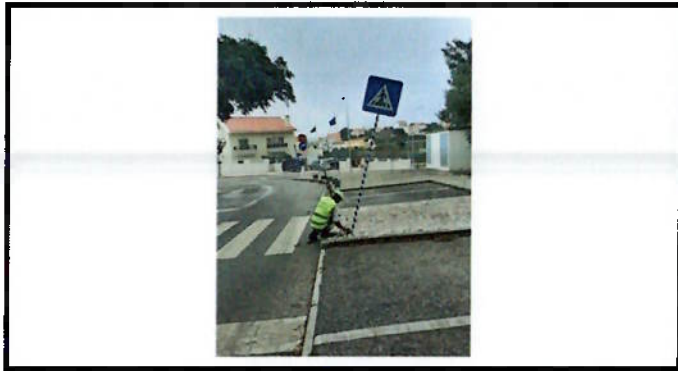
Aprumo de sinalização vertical
