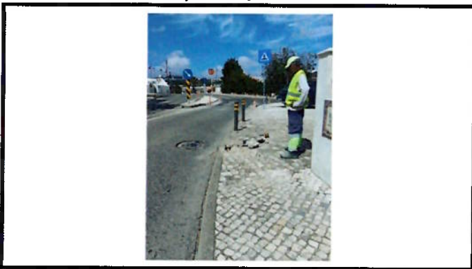
Reposição de pilarete
