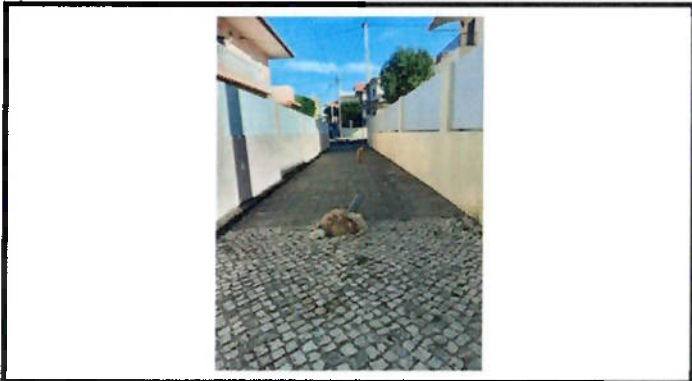
Reposição de pilarete
