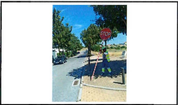
Apromo de sinalização vertical
